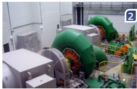
1. Vista externa da casa de força | External view of the power house
