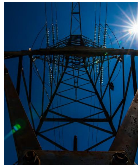
Torre de Transmissão em São Mateus (ES)
