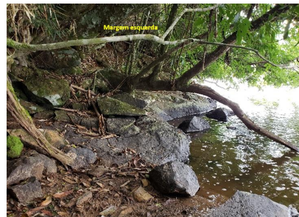
Figura 48– Maciço basáltico da margem esquerda com a presença em menor quantidade de blocos soltos e matacos
