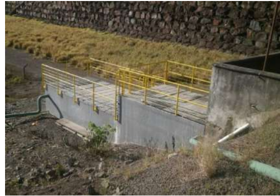
Foto 81 – Caixa separadora água e óleo localizada na parte externa.
