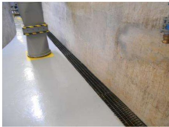
Foto 80 – Canaletas de drenagem na área das UGs.
