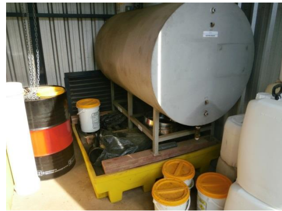
Foto 74 – Tanque de óleo contaminado sobre bacia de contenção com válvula para direcionada para fora da mesma.
