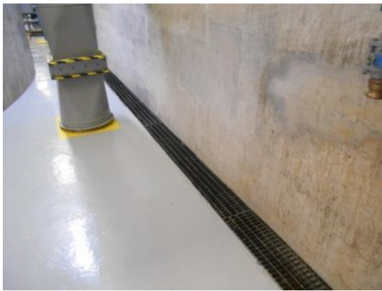
Foto 73 – Canaletas de drenagem na área das UGs.
