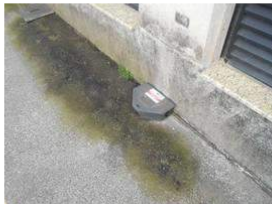
Foto 52 – Armadilha para controle de roedores na área externa da casa de força.
