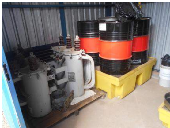
Foto 42 – Resíduos perigosos armazenados sobre bacias de contenção.
