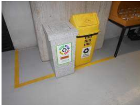
Foto 44 – Coletores na área interna da Casa de Força devidamente identificados.
