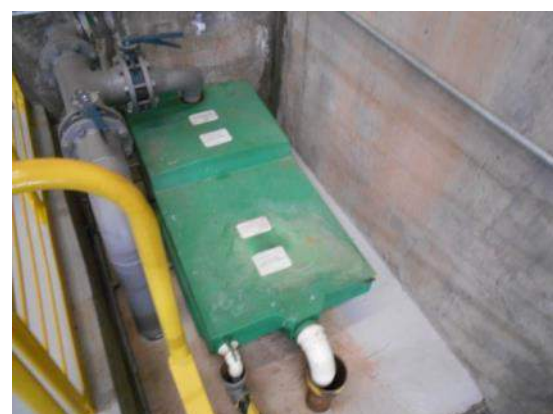
Foto 51 – Caixa separadora água e óleo localizada no interior da Casa de Força.
