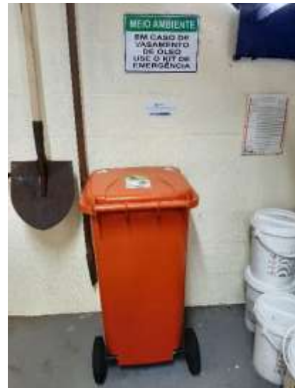
Foto 64 – Kit de mitigação no almoxarifado da Casa de Força.
