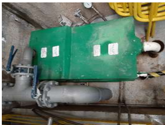
Foto 69 – Caixa separadora água e óleo localizada no interior da Casa de Força.
