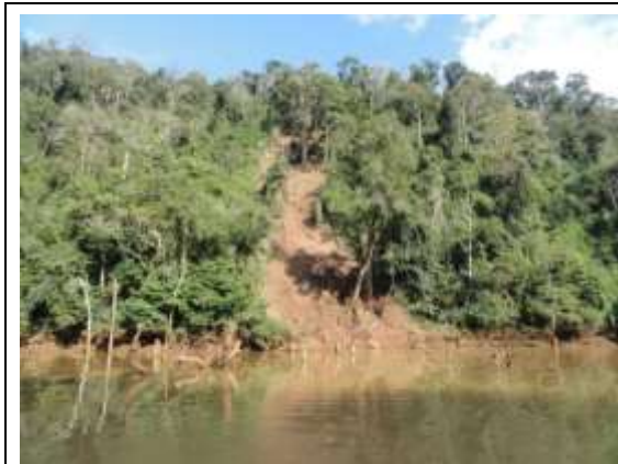
Foto 5 - Vista geral do novo local com processo erosivo na margem esquerda do reservatório. Ponto 24. Vistoria realizada em 08/08/17.
