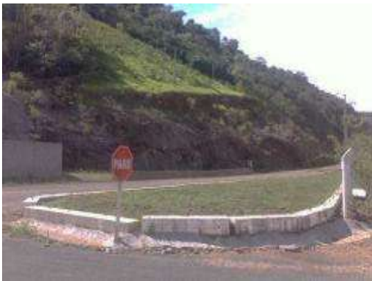
Foto 1 - Situação inicial do Ponto 10. Vistoria realizada em 10/05/2010.
