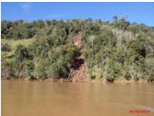
Foto 7 - Situação inicial da instabilidade no Ponto 20. Vistoria realizada em 05/08/14.
