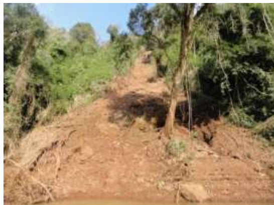
Foto 12 – Detalhe do escorregamento de solo e vegetação no novo processo erosivo registrado. Ponto 24. Vistoria realizada em 08/08/17.
