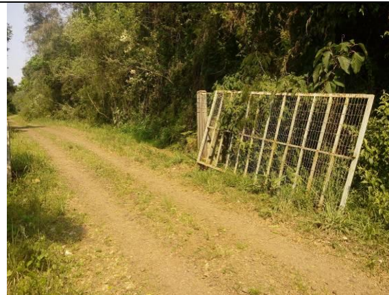
Foto 02 – O portão se encontra danificado sem as dobradiças, com alguns danos na tela, mas pode ser reutilizado.
