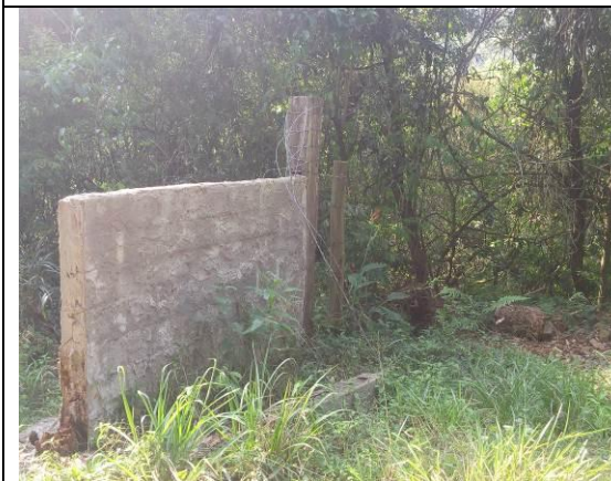
Foto 03 – Parte do muro foi danificado e a cerca que faz a divisa com a mata foi arrancada..
