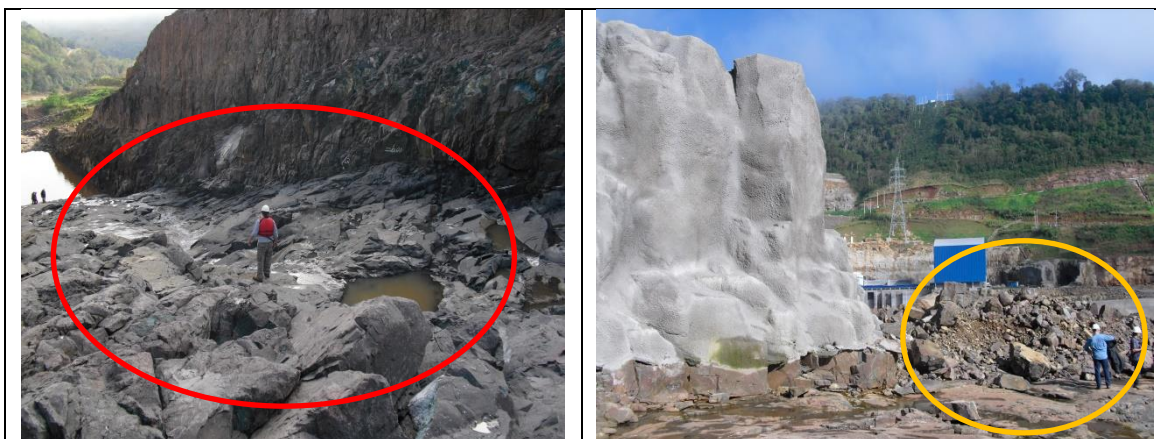
Foto 03 – 04 Detalhes do canal do vertedouro numa vistoria realizada em final de 2009 antes das cheias é possível ver a rampa que foi posteriormente totalmente erodida (no detalhe vermelho) com as cheias. No detalhe em laranja é possível ver matacões empilhados na lateral do vertedouro na esquerda hidráulica que formavam uma berma que também foram arrastados para o rio.
