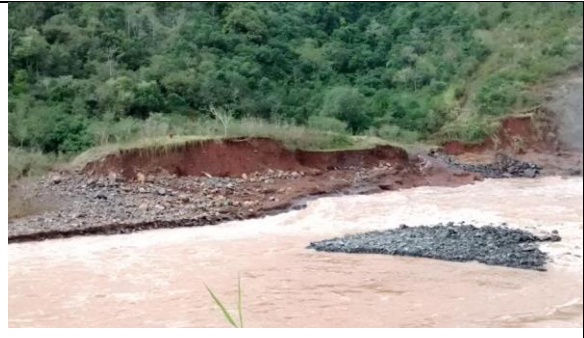
Foto - 12 – Detalhe do bota fora destruído na margem direita nas proximidades do vertedouro, esse local havia sido recuperado e incluído no PRAD.
