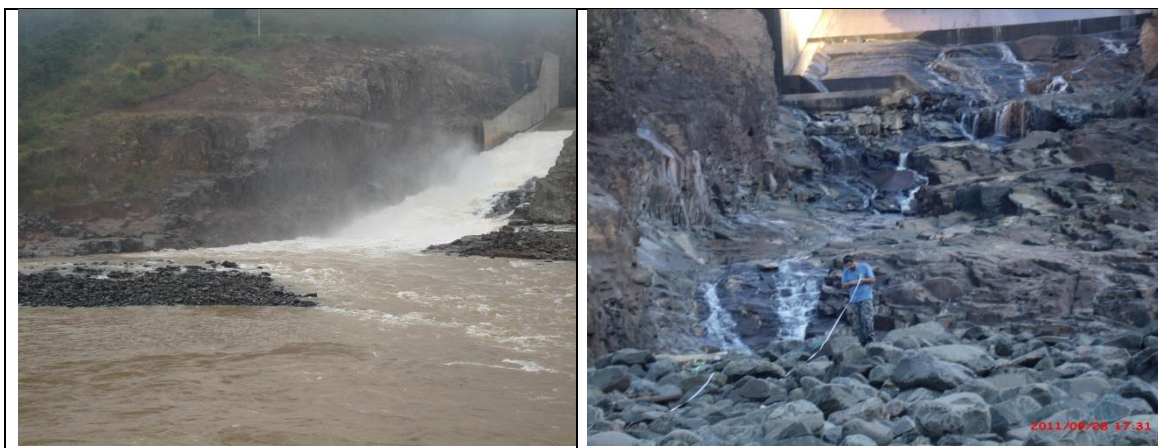
Fotos 03 e 04 - Formação da barra no leito do rio com material oriundo do piso do vertedouro.
