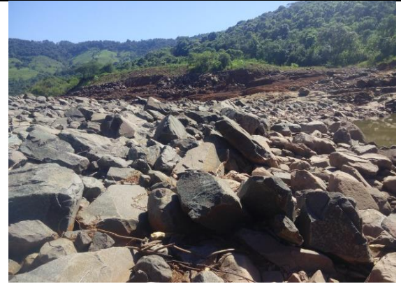
Foto 22 Situação atual, o bota-fora foi novamente lançado dentro do leito do rio.
