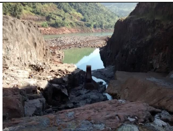
Foto 14 – Vista da erosão do vertedouro.
