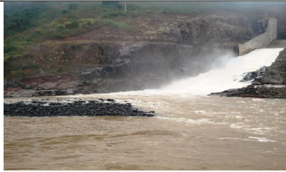
Foto – 11 – Vista da frente da formação de uma nova barra com material carreado do vertedouro e do resto do material rochoso do bota-fora.
