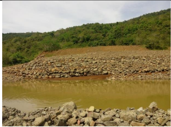
Foto 22 Bota fora margem direita na saída do vertedouro com localização impropria.
