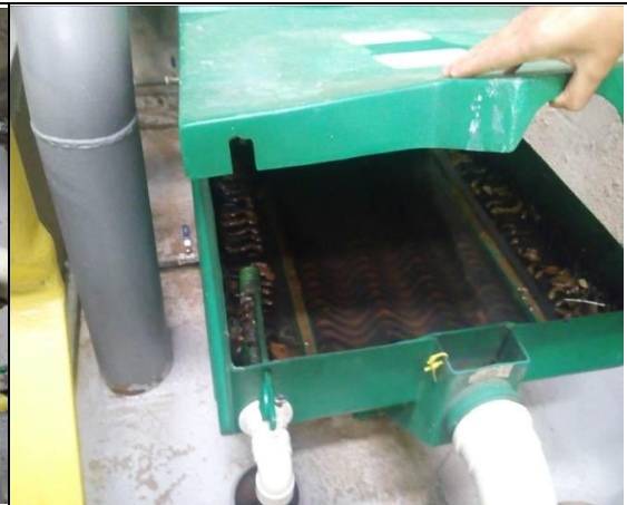
Foto 12: Sistema em funcionamento sem problemas
