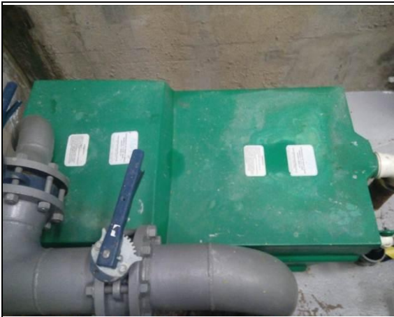
Foto 11: Sistema de separação de água e óleo.
