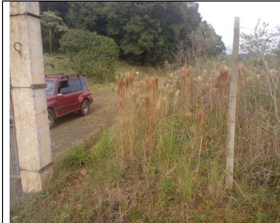
Foto 01 – Vista da entrada do pórtico da subestação, cerca furtada.
