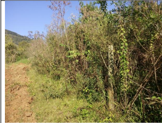
Foto 15 – Vista da cerca com vegetação caída no acesso ao vertedouro.
