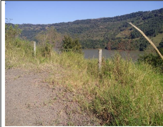
Foto 13 – Local onde se encontra o mirante, com cerca danificada faltando arrame, local de risco de queda, falta sinalização de perigo.
