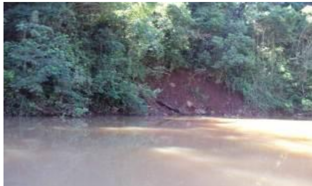
Foto 09: Situação inicial da instabilidade no Ponto 14
