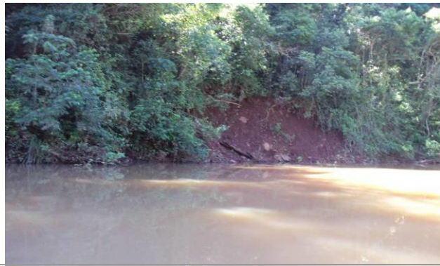
Foto 09: Situação inicial da instabilidade no Ponto 14
