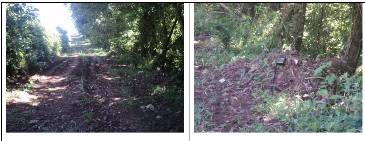
Foto 01 - Pequena bacia formada no acesso junto ao local onde a água da chuva se acumulou ocasionando o encharcamento do solo. Foto 02 – Neste local existe o início de uma pequena drenagem natural que se encontra obstruída por uma camada de solo depositada junto a borda da estrada, o que pode ter contribuído para obstrução e falta de escoamento da chuva.
