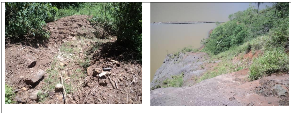
Foto 07 – Material fino com pedriscos ficou depositado junto a um antigo acesso de serviço que serviu de zona de amortecimento. Foto 08 – Final da drenagem natural com desemboque junto ao canal da tomada de água do empreendimento.
