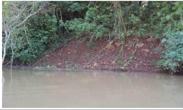
Foto 11: Situação inicial da instabilidade no Ponto 15
